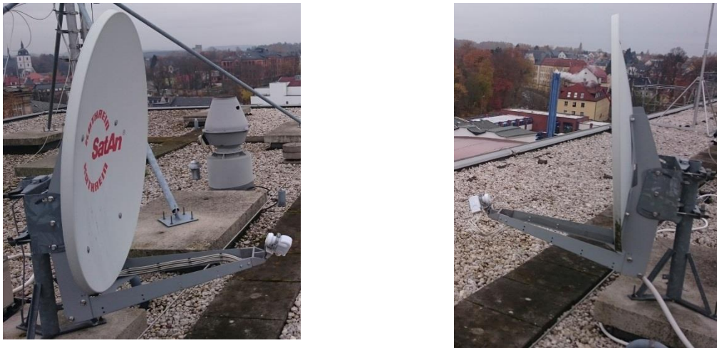
Abbildung 1: auf den Telstar 11N 37,5 ° W ausgerichtete Satellitenantenne
